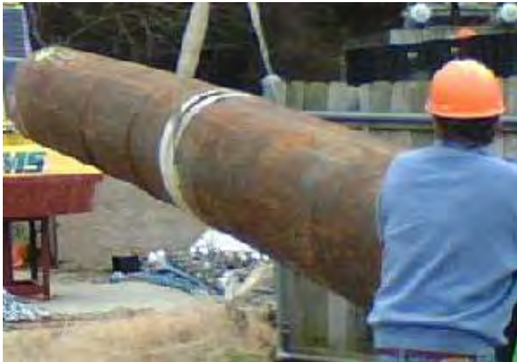
Pipe from El Paso Gas
